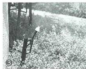
③ 全戸に自動散水システムを導入し、定期的に道路や庭に散水。水の力も使って冷却する
