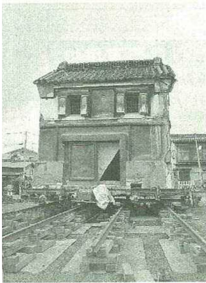
100トンもある蔵を移動させながらの造成工事が進められている
